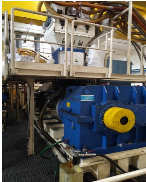
Obr. 2: Dávkovací šachty + extruze
