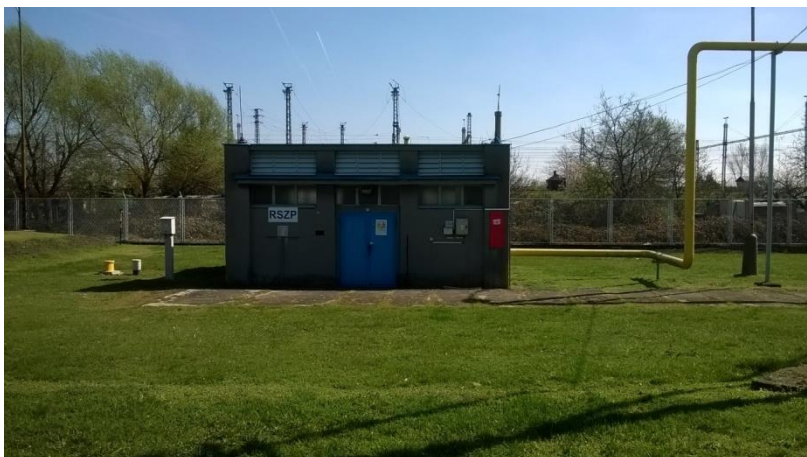
Obr. 4 Regulační stanice zemního plynu
