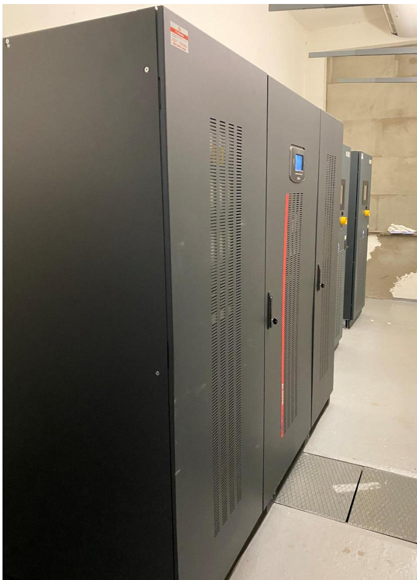
Obr. 26: UPS (zdroj: autor)
