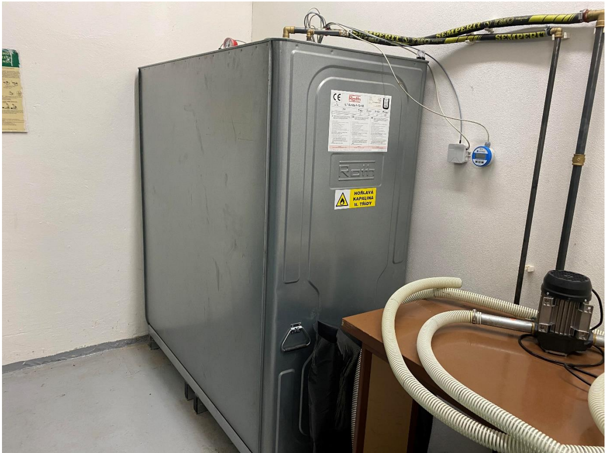
Obr. 27: Nádrž na PHM (zdroj: autor)
