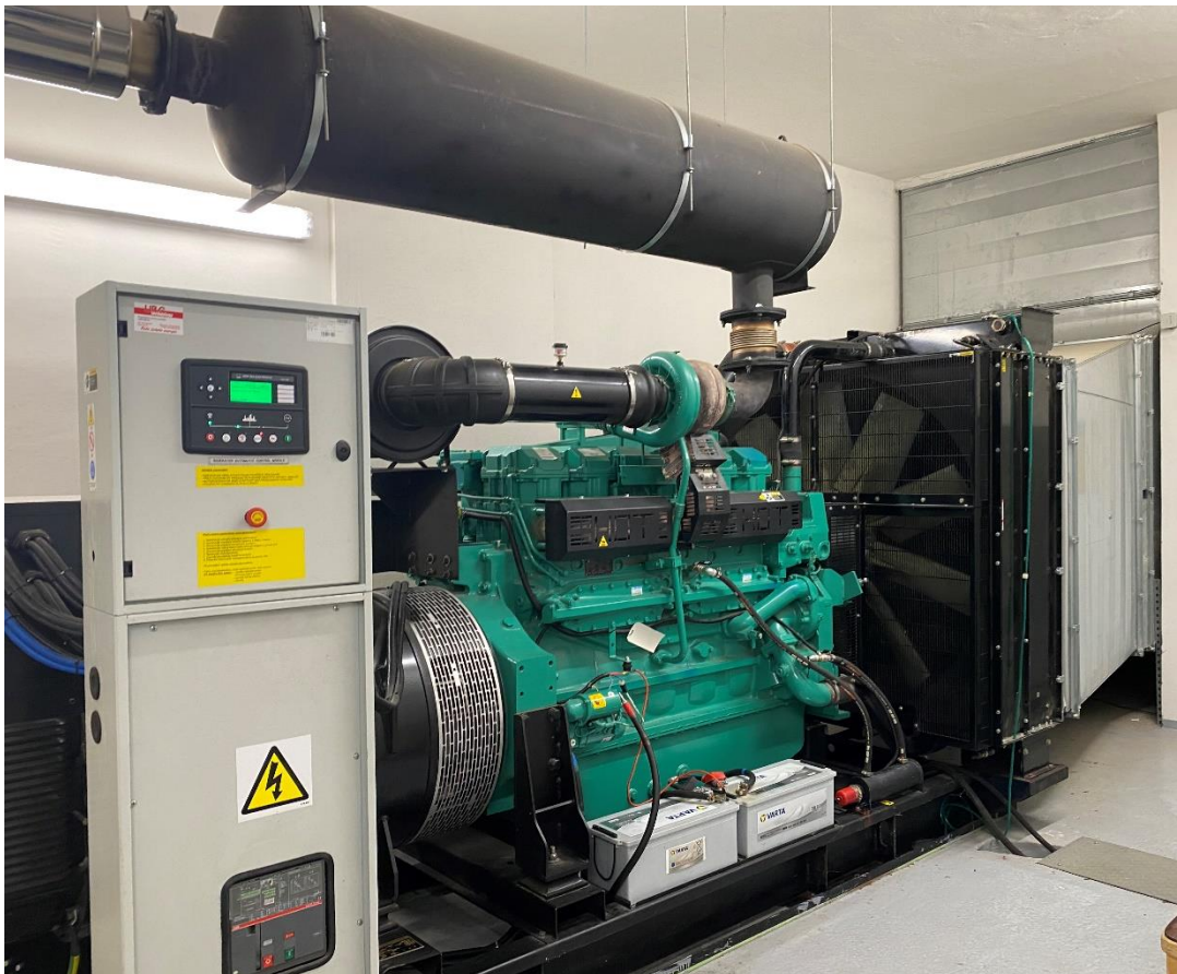
Obr. 24: Náhradní zdroj elektrické energie (zdroj: autor)
