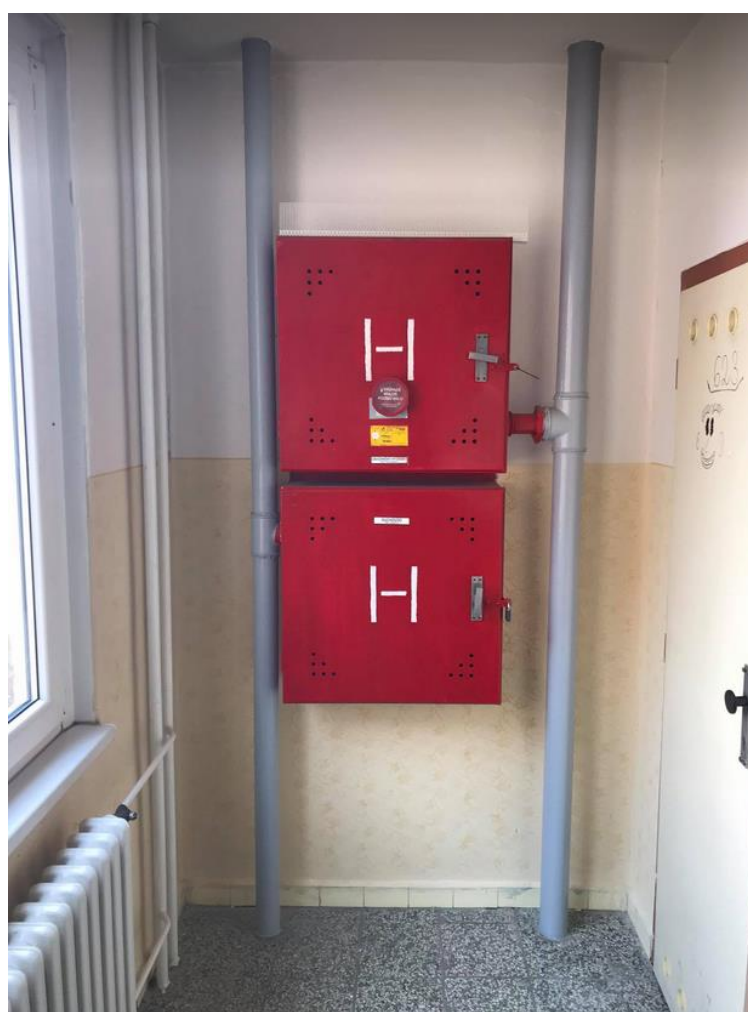
Fotodokumentace F – protipožární ochrana v interiéru (zdroj vlastní)
