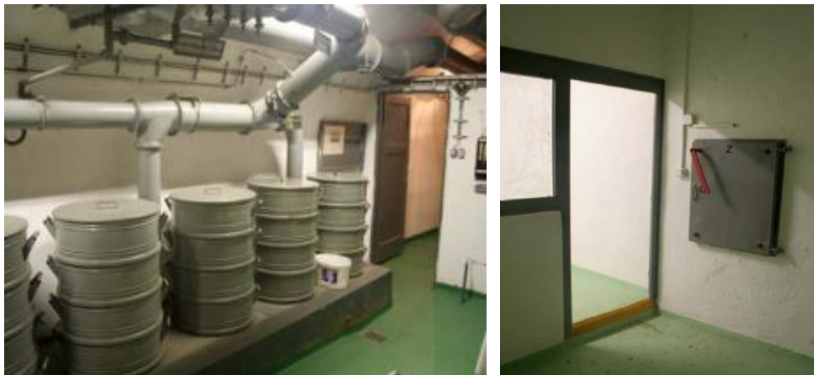
Obrázek 234 – Vlevo je filtroventilační komora se zabudovaným filtroventilačním zařízením a vpravo lze vidět nouzový výlez (východ) pro nouzové opuštění úkrytu 406 . [Zdroj: Obe-234]
