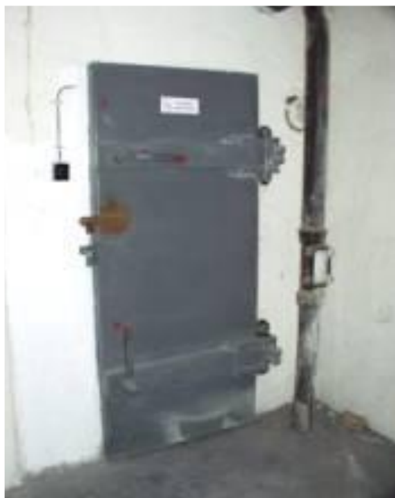
Obrázek 231 – Plynotěsné tlaku odolné vstupní dveře do stálého tlakově odolného úkrytu. [Zdroj: Obr-231]
