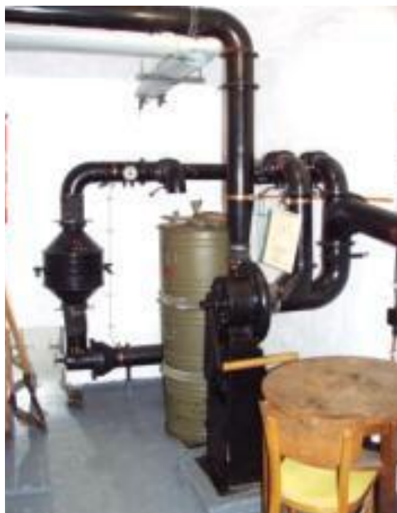
Obrázek 232 – Filtroventilační zařízení s filtry. [Zdroj: Obr-232]
