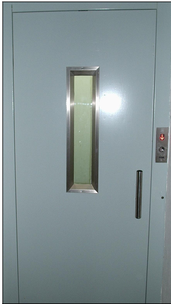
Obr. 7 Příklad kabíny výtahu nízké budovy
