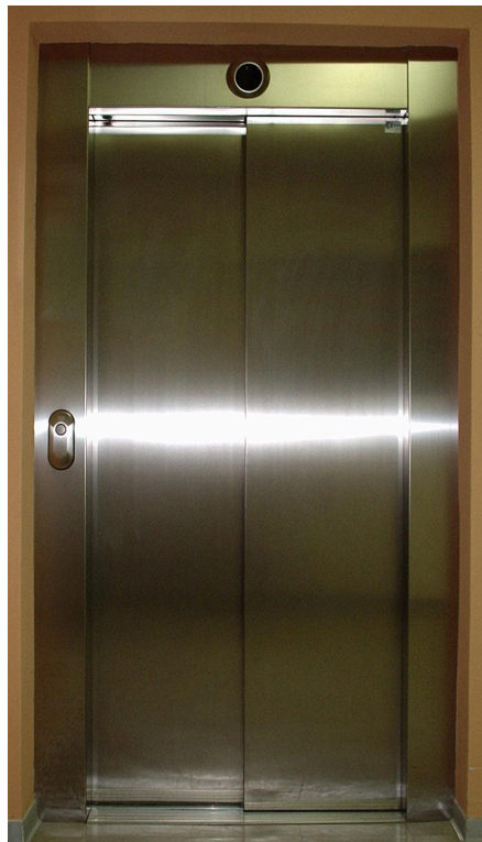
Obr. 8 Kabína výt'ahu výškovej budovy
