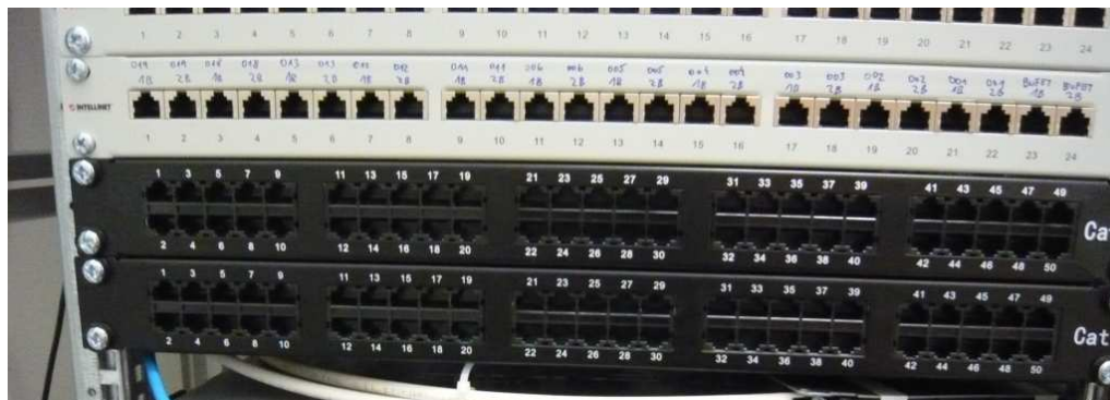
Obr. 26 50portový telefonny patch panel v čiernom prevedení, nad nim je umiestnený biely patch panel s 24 portami.
