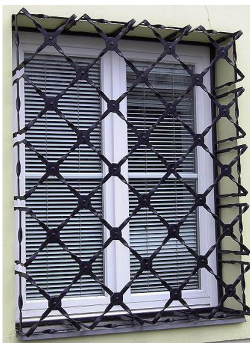
Obrázek 44: Příklad instalované mříže
