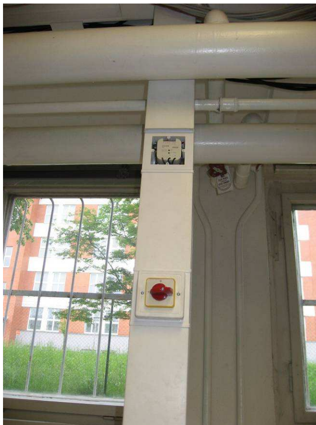
Obr. 26 Umístění ovládání žaluzií na elektroinstalačních pilířích
