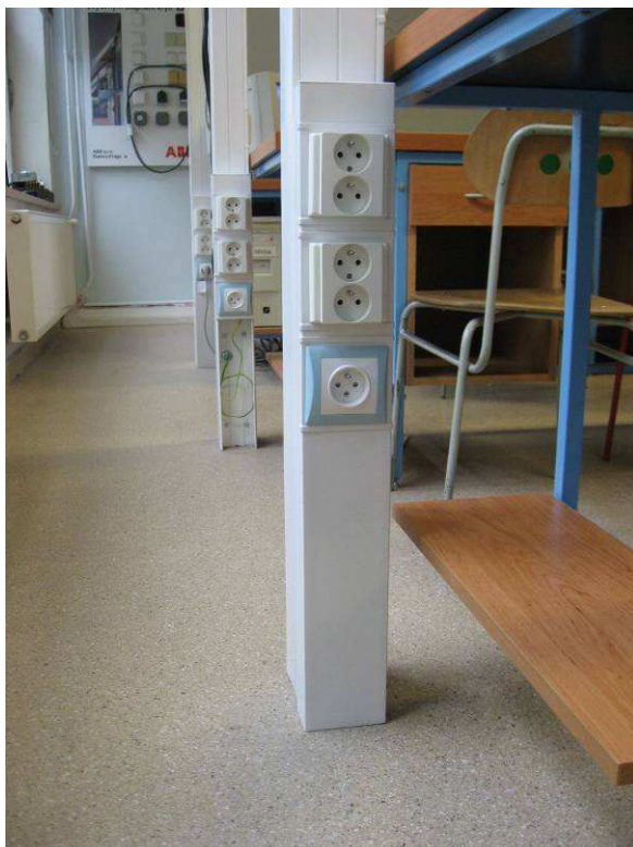
Obr. 25 Ukázka zásuvkových rozvodů na elektroinstalačních sloupech
