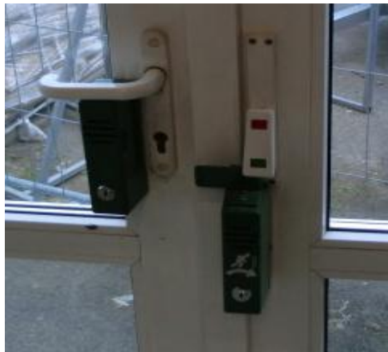
Obr. 25. Zabezpečení nouzového východu
