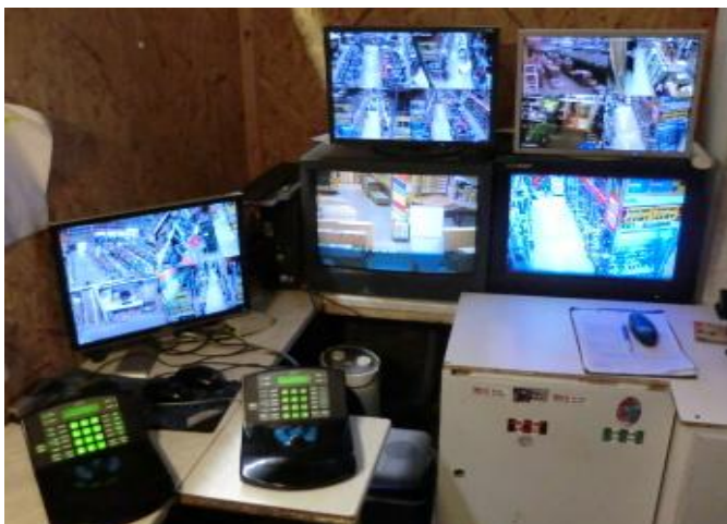
Obr. 20. Velín kamerového systému
