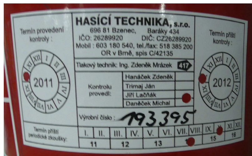
Obr. 21: Štítek o provedené revizi [16]
