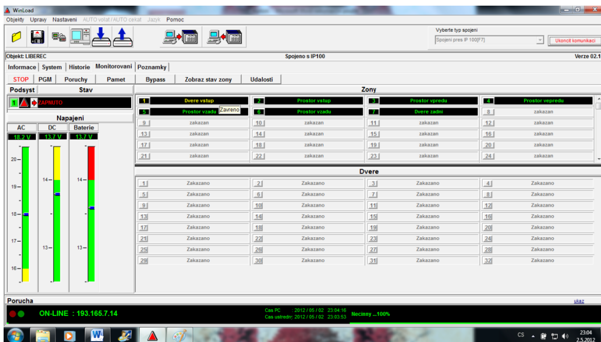
Obrázek 52: Signalizace otevření vstupních dveří
