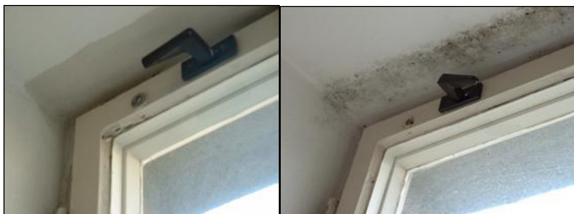
Obrázek 6 Projev tepelného mostu tvořeného železobetonovým okenním překladem – vlhkost a plíseň
