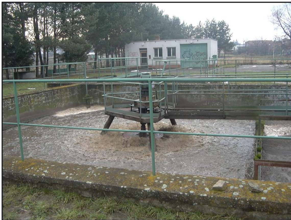
Obrázek 9 Čistírna odpadních vod v Pustiměři
