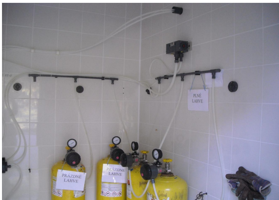
Pohledy na rozvod chloru v chlorovně.
