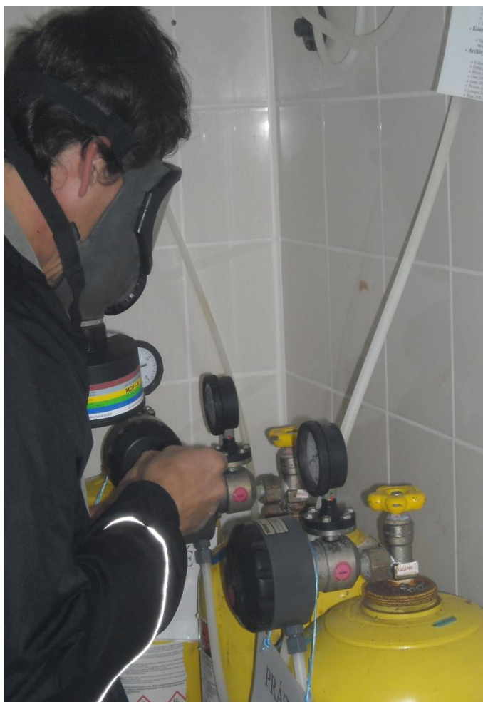
Pohled na výměnu chlorátoru u tlakové lahve
