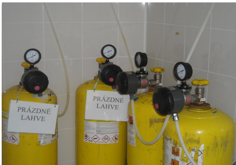
Pohled na ventily a chlorátor umístěný na tlakové láhvi.
