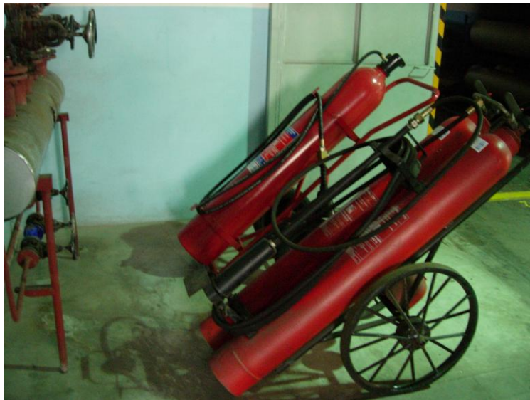
Obr. 5 CO 2 hasicí přístroje na budově 14 [Zdroj: vlastní]
