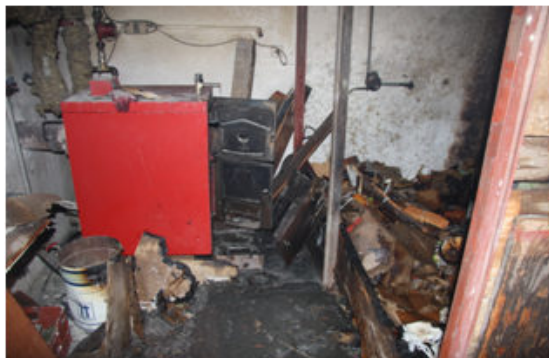
Kotel na pevná paliva v prostoru kotelny
