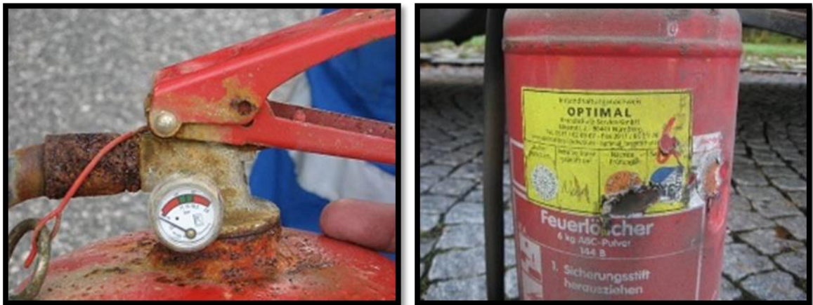
Obrázek 9 - Nefunkční hasicí přístroj a hasicí přístroj s prošlou lhůtou kontroly [Zdroj: 4]
