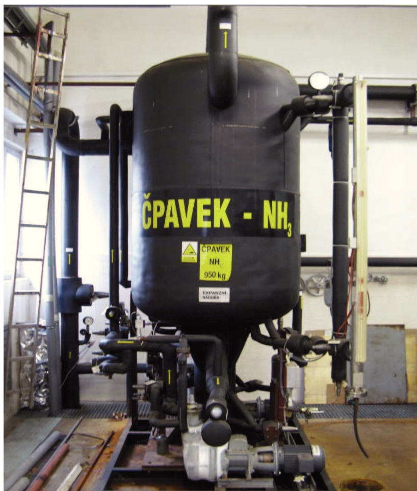
Obr. č. 17 Skladovací nádrž čpavku
