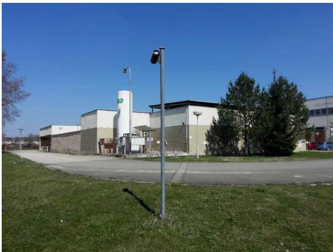
Obr. 7. Pozemní zásobník kapalného kyslíku monitorován pomocí CCTV
