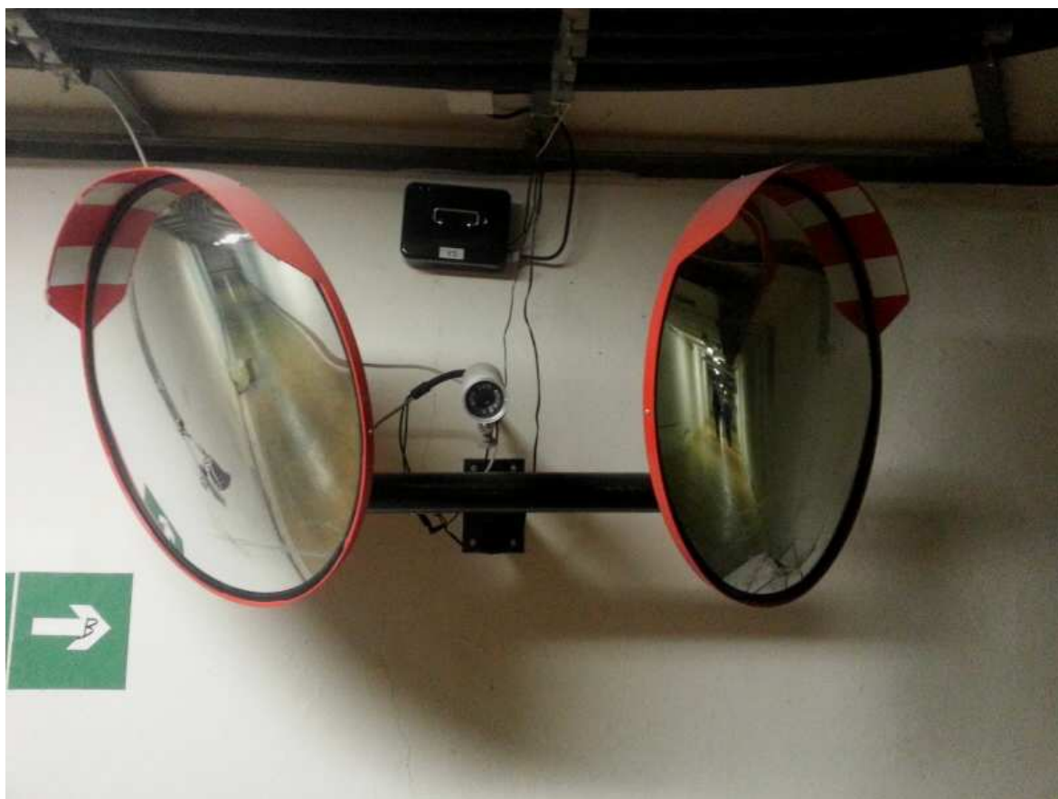
Obr. 15. Kamerový systém v transportních chodbách
