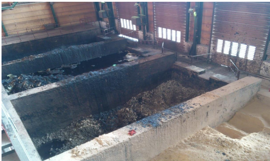
Obr. 2 Sklad pevných odpadů
