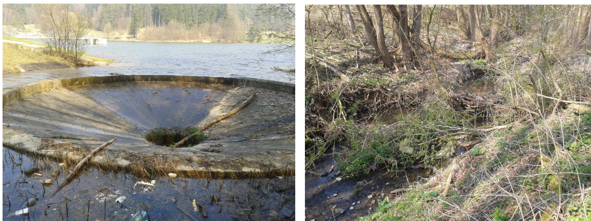
Obr. 18: Zanesené odtokové cesty
