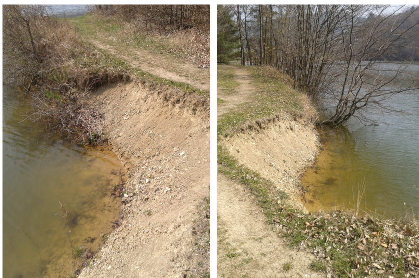
Obr. 17: Eroze břehu vodního díla
