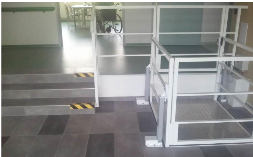
Obr.: 21 Pohled na špatně řešený bezbariérový vstup
