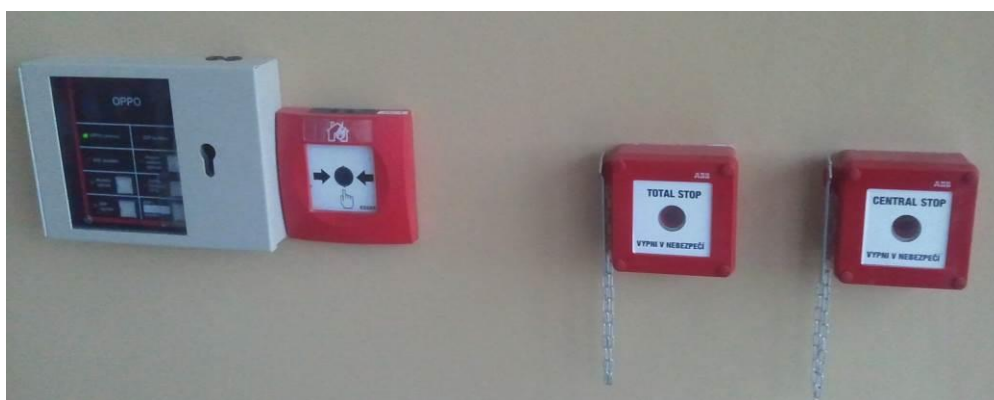
Obr.: 27 OPPO a tlačítkový hlásič u hlavního vstupu do DZR
