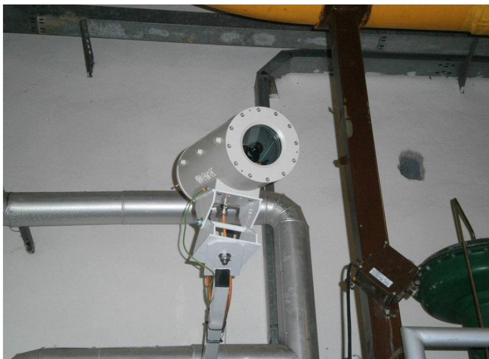
Obr. 12. Kamera určená pro výbušná prostředí používaná na provozech PZP.
