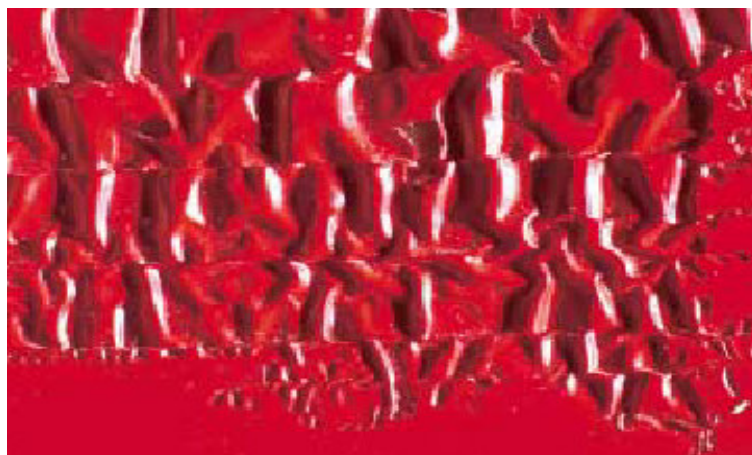
Obr. 15 : Svraštělý – popraskaný povrch gelcoatu
