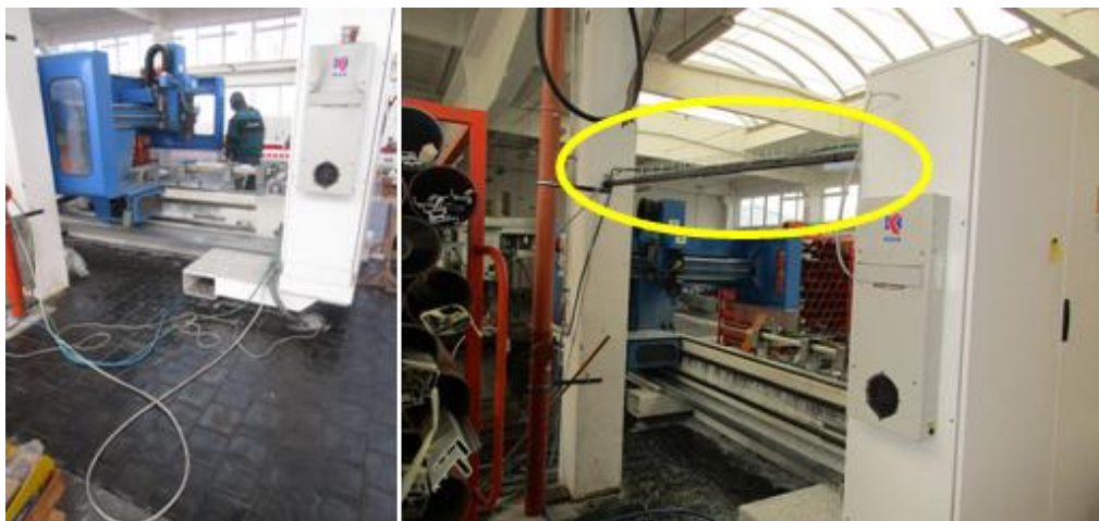
Obr. 60. Uložení strojní kabeláže „před a po“ 5S (vlastní zpracování)
