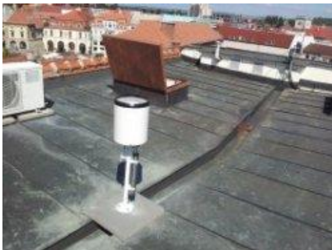
Obrázek 12 Srážkoměr na střeše Městského úřadu [25]
