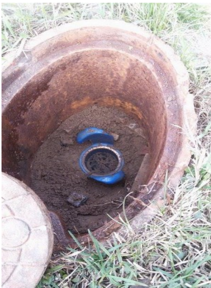
Obrázek 9 částečně vyčištěný požární hydrant [19]
