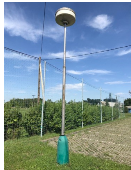
Obrázek 13 Stávající stav veřejného osvětlení v obci Loučany (vlastní zpracování)
