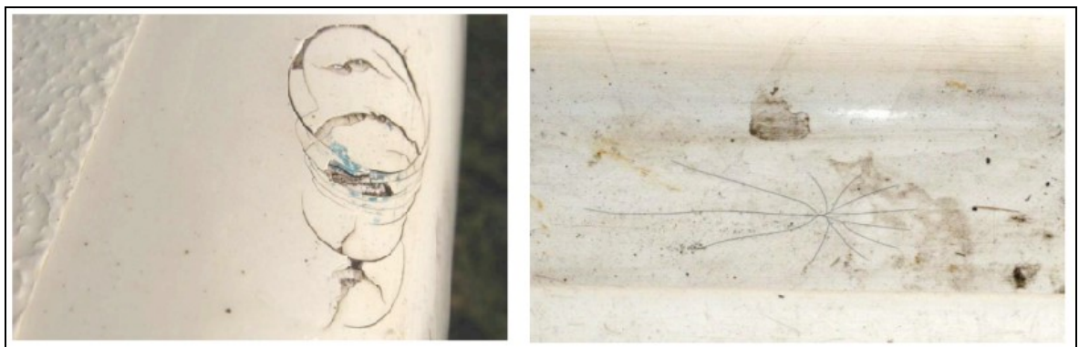
Obrázek 33 - Popraskání gelcoatu VSP [26]
