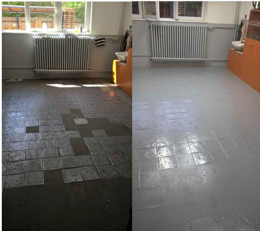
Obr. 48. Srovnání nové a staré podlahy
