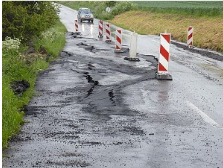
Obrázek 8. Rozpad silnice Koryčany[25]
