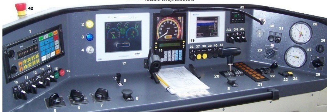
Obr. 13 Podrobný popis stanoviště strojvedoucího u motorové jednotky řady 814 [34]
