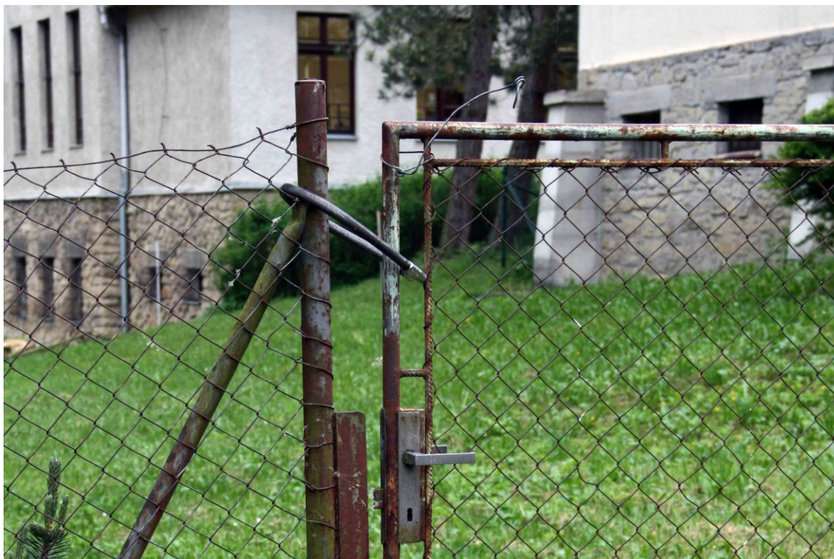
Obrázek 19 Detail aktuálního zabezpečení před budovou staré školy
