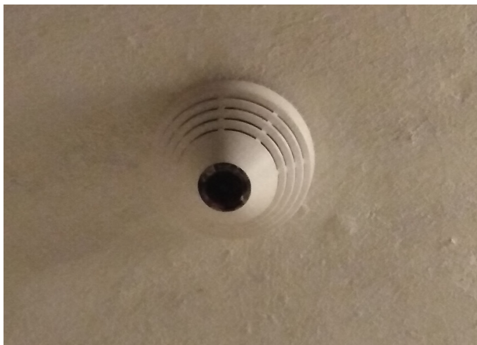
Obrázek 10 – Požární signalizace JA – 80s
