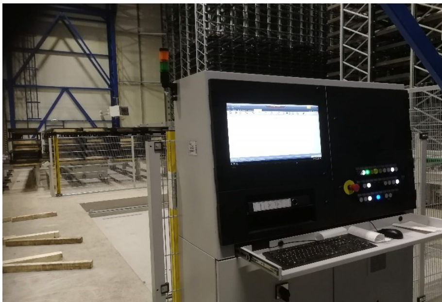
Obr. 51. Stanice č. 3. expedice a sklad automatického zakladače [34]
