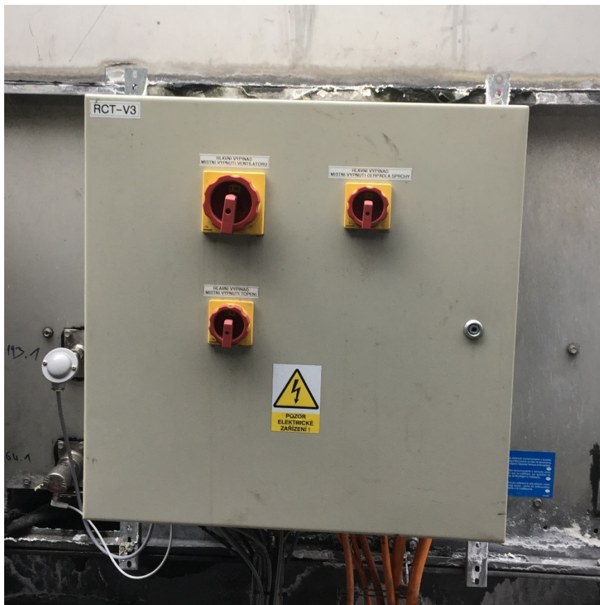
Obrázek 38 - Podružný rozvaděč chladicí věže
