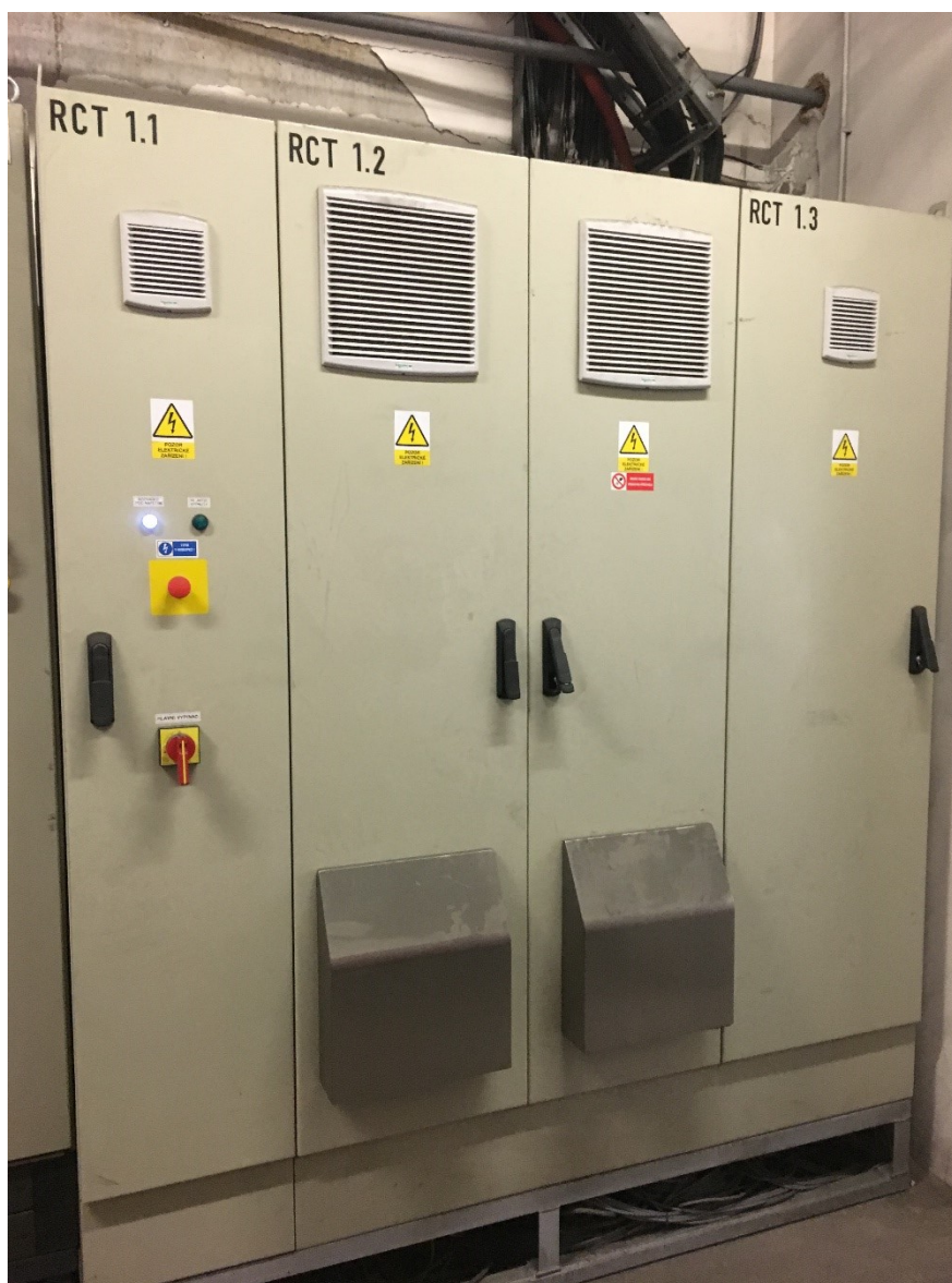
Obrázek 37 - Centrální rozvaděč řízení chladicích věží
