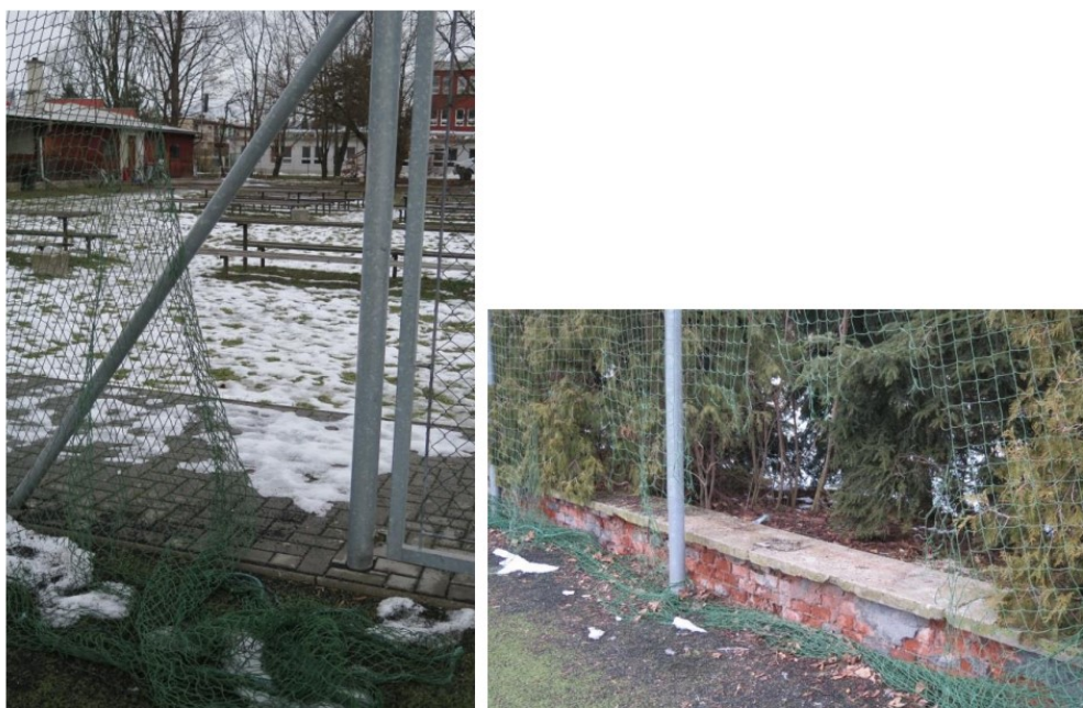
Obr. 16 Poničené oplocení víceúčelového hřiště
