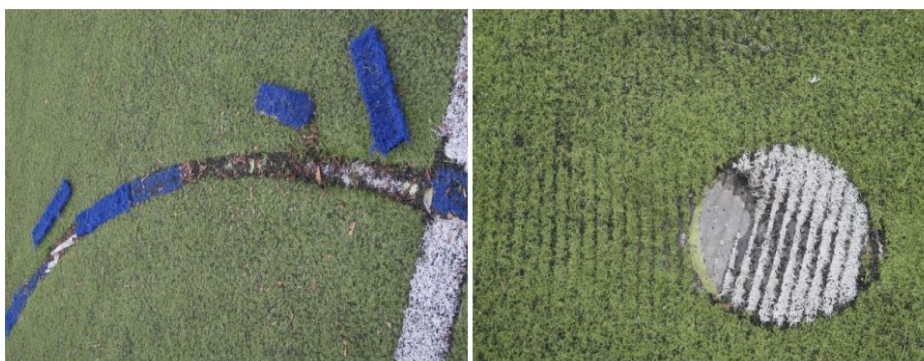
Obr. 17 Zničený povrch víceúčelového hřiště
