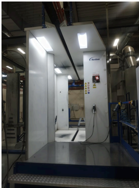
Obrázek 11: Lakovací kabina (Zdroj vlastní)
