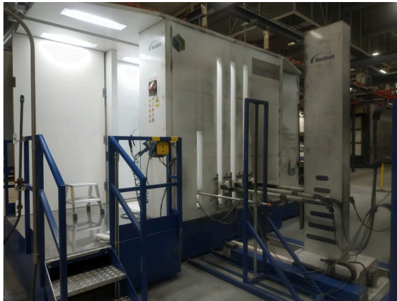
Obrázek 17: Lakovací kabina (Zdroj vlastní)
