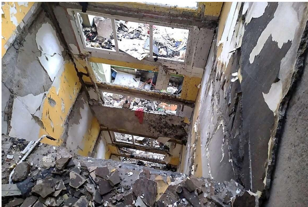
Obr. 12 Zrútené schodisko bytového domu [25]
