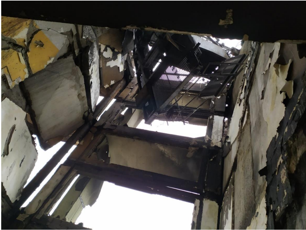
Obr. 11 Zrútené schodisko bytového domu [25]
