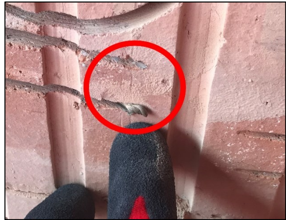
Obrázek 38. Poškozená výztuha při řezání.
