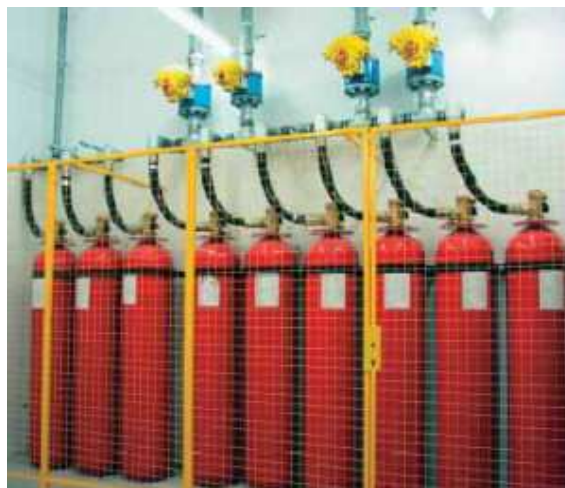
Obr. 28. Tlakové láhve stabilního hasičího zařízení KD-1230 s plynem Novec 1230
