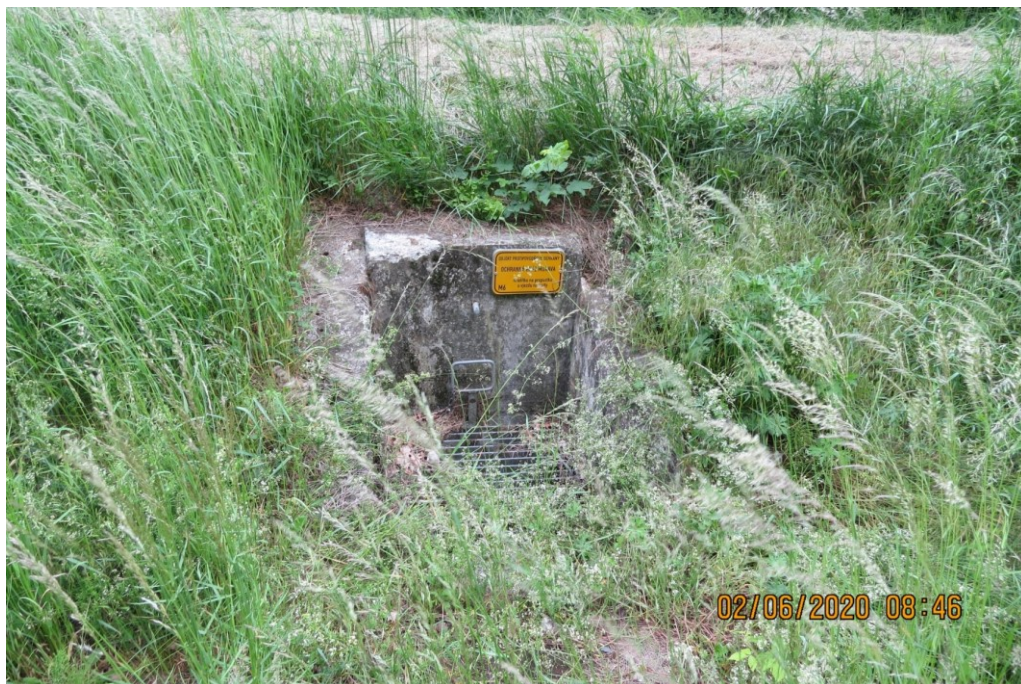
M6 – Ochranná hrát Morava – (Hradítko na propustku u vjezdu na kurty) [1]
