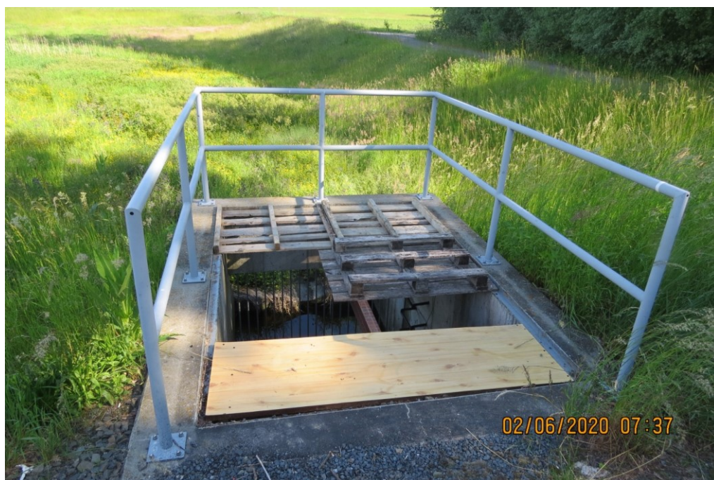
H1 – Retenční nádrž (Součást odvodnění D55). [1]
