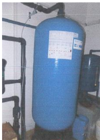
Obrázek 4 Písková filtrace ve vodojemu 2x 250 m 3 [16]
