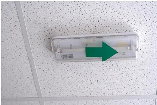
Obrázek 5 – Nouzové osvětlení únikových východů [7]
