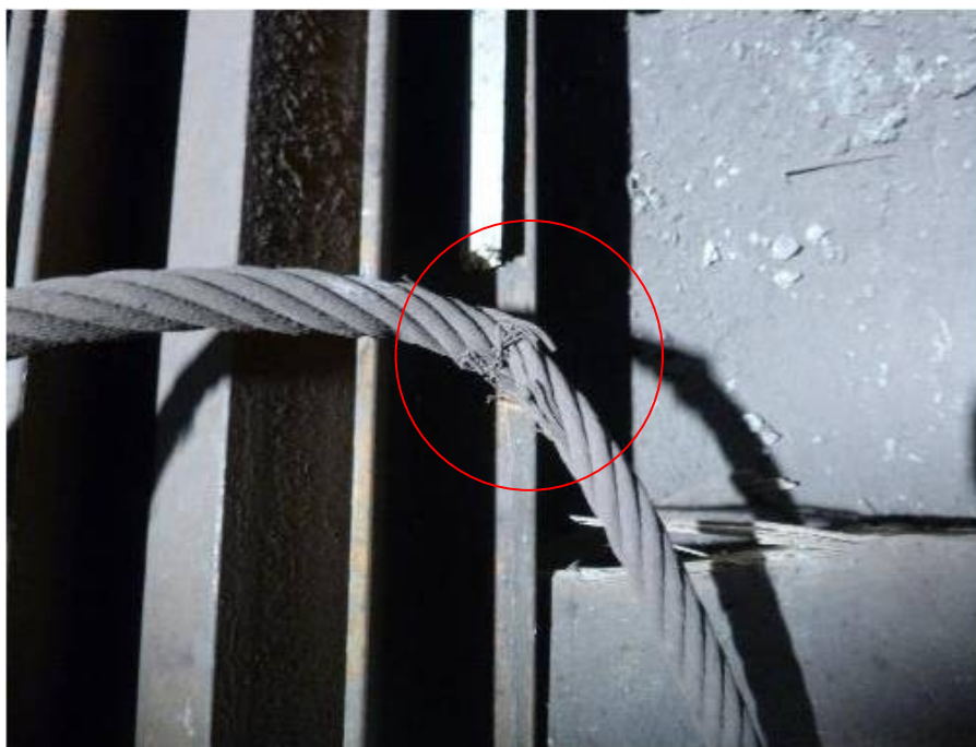
Obrázek 11 - Poškozený vázací prostředek.
