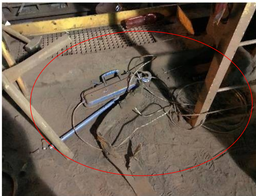
Obrázek 3 - Nevhodné uložení vázacích prostředků – vázací prostředky na zemi.
