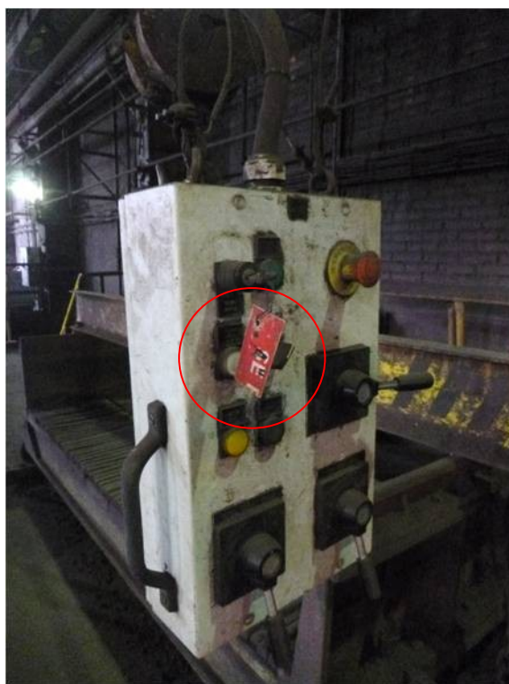
Obrázek 2 - V ovládní jeřábu jsou ponechány klíče bez dozoru. Hrozí zde riziko zneužití a neoprávněné manipulace.
