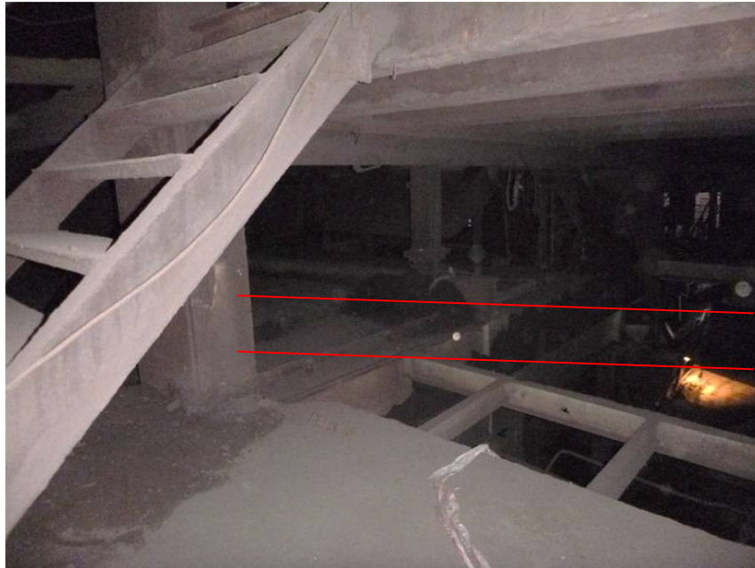
Obrázek 1 - Na pracovišti, kde došlo k odvaření zábradlí, hrozí riziko pádu z výšky do hloubky. Je nutno doplnit přechodnou zábranu a tím zajistit kolektivní ochranu
