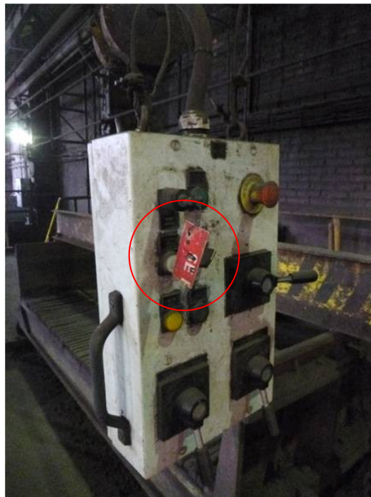
Obrázek 2 – V ovládání jeřábu jsou ponechány klíče bez dozoru. Hrozí zde riziko zneužití a neoprávněné manipulace.
