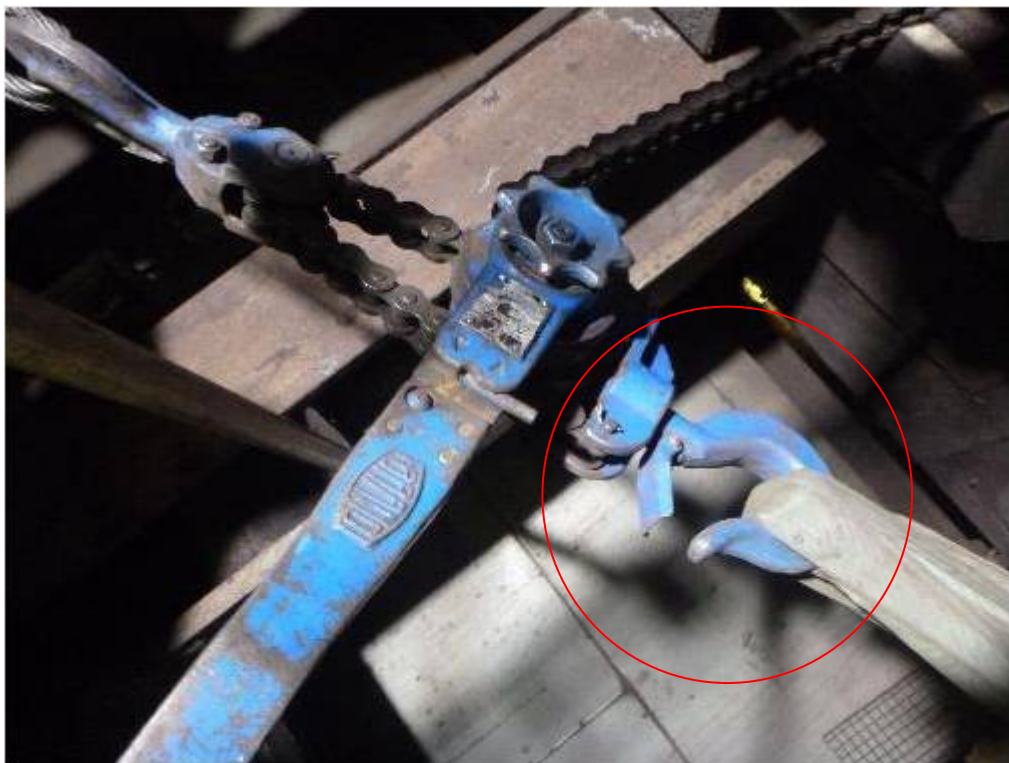
Obrázek 6 - Na pracovišti se nachází vázací prostředek s hákem s poškozenou pojistkou.
