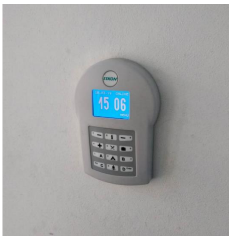
Obrázek 10 Čtečka pasivních RFID karet přístupového systému
