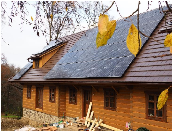
Obrázek 12 Fotovoltaická elektrárna (vlastní)
