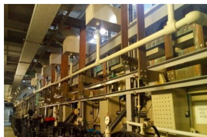
Obrázek 21 Nádrže procesních van (interní zdroj)
