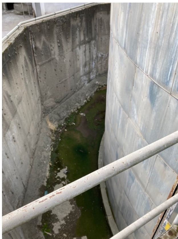
Obrázek 7 Havarijní jímka (Zdroj: vlastní)
